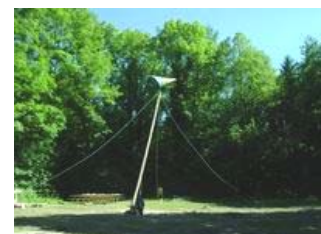
Am Nachmittag fingen wir an die Stadt abzureissen. Hier wurde die Hauptsäule der Kirche mit der Motorsäge gefällt
